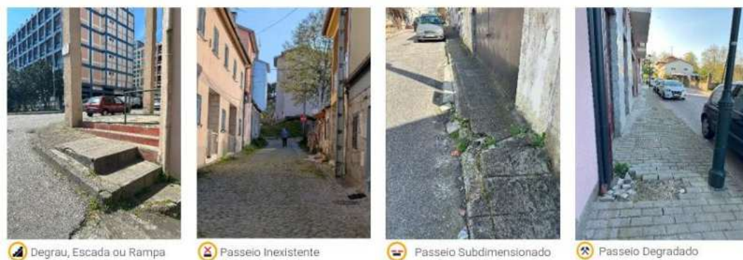
Fig. 16 Tipologia das Barreiras de Acessibilidade – Subgrupo de Passeios
