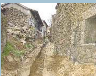
Saneamento Básico de São Vicente da Raia
