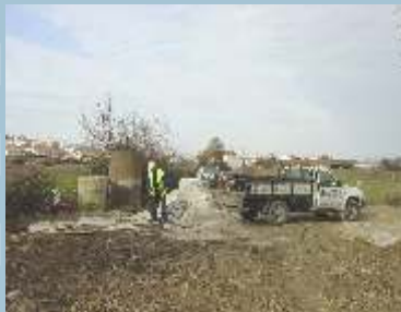
Estação elevatória do Emissário de Samaiões
