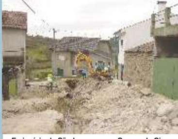
Emissário de São Lourenço ao Campo de Cima
